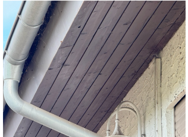
Abb. 9: Dachüberstand an der Gebäudenordseite ohne freitragende Balken und Spalten.
