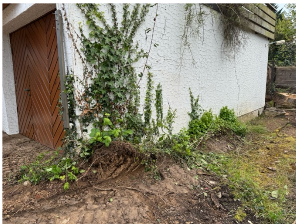
Abb. 6: Beginnender Efeu-aufwuchs an der Garage am nordwestlichen Gebäude.
